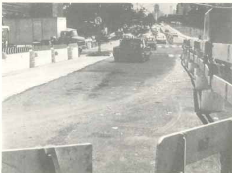
4 — Mesmo ocupando parte da pista de sentido contrário, o fluxo de veículos está devidamente protegido pelos tapumes. A sinalização noturna é essencial nos trechos de mudança de direção obrigatória.
